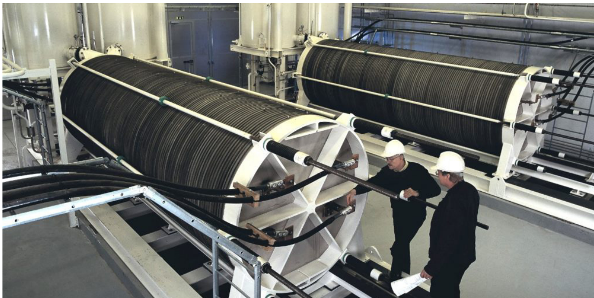
Figure 34 — Électrolyseurs fonctionnant avec l'électricité photovoltaïque 52
