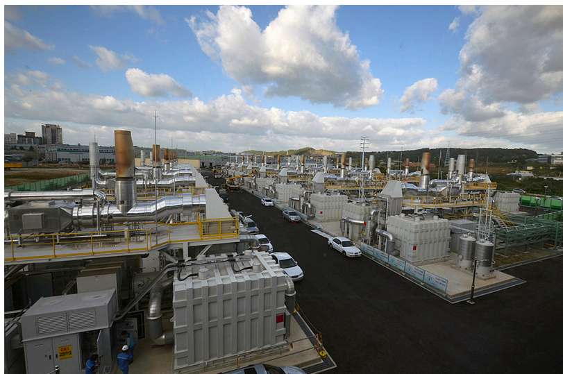
Figure 50 — Ensemble de PAC de 59-Megawatt Gyeonggi Green Energy à Hwasung ; en 2016 c'était la plus grande centrale de ce type. Actuellement un parc de 200 MW est en construction sur ce site.
